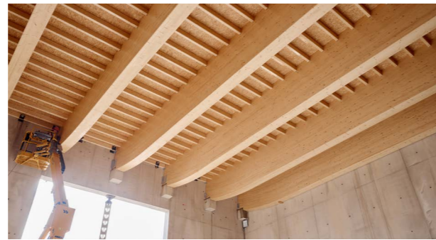
La charpente bois des gymnases annexes de l'Arena Porte de la Chapelle
