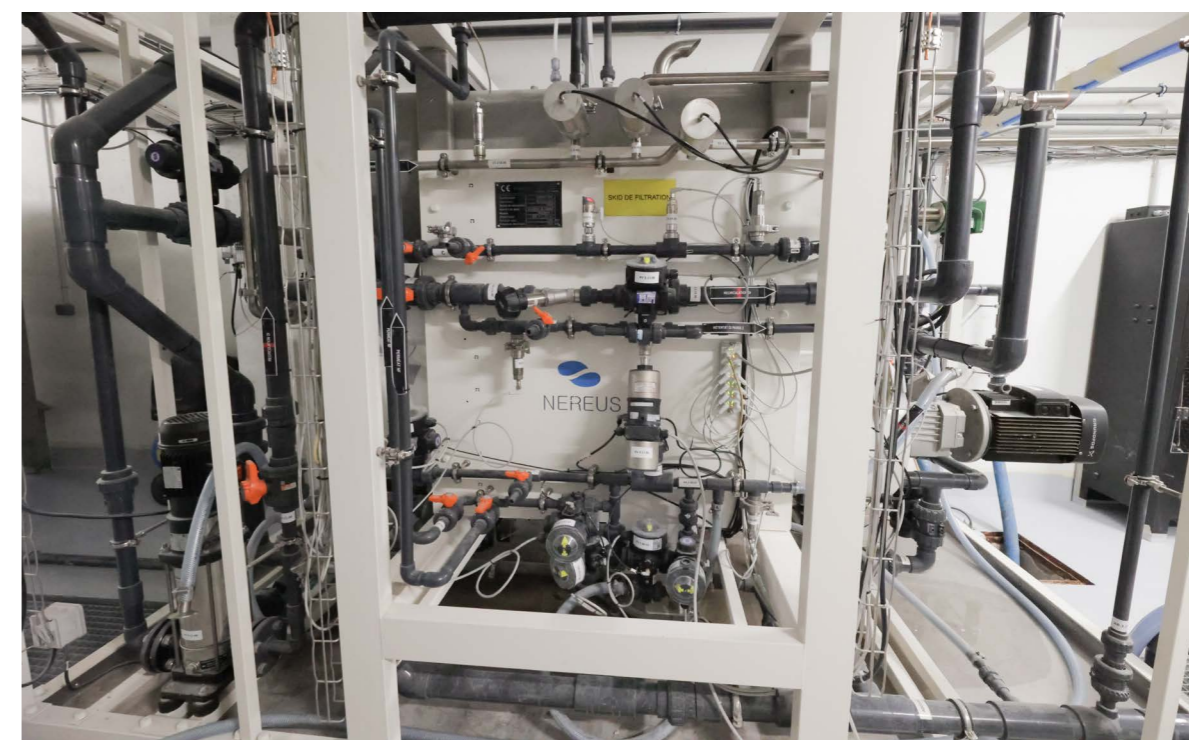
Une des salles de machinerie assurant le traitement des eaux usées au sous-sol du Bâtiment Cycle
