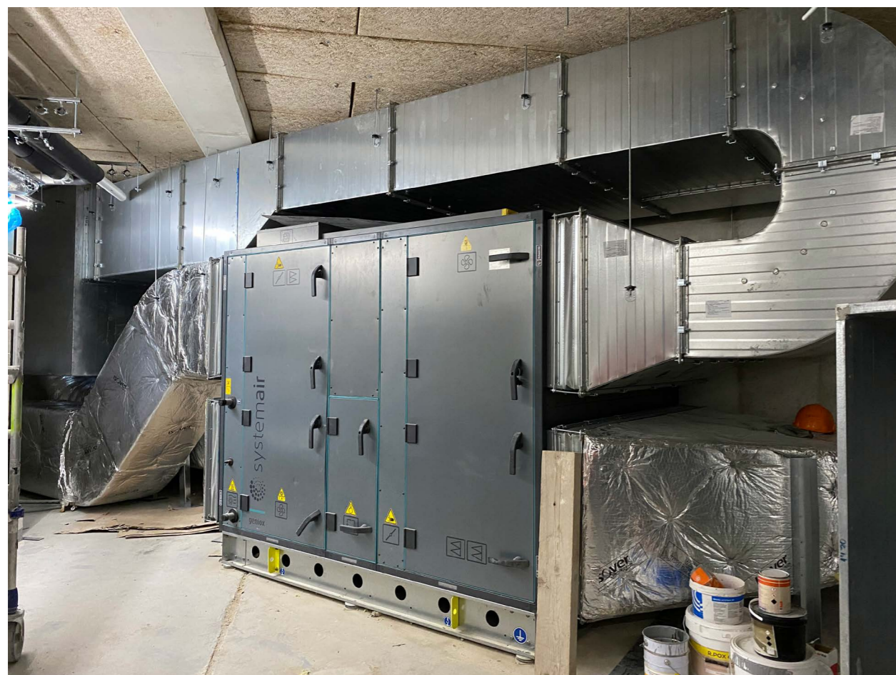
CTA des vestiaires de football du Gymnase du Bourget
